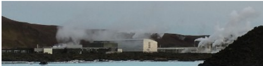
Centrale géothermique de Svartsengi ( Islande ) 2012- S Casazza
